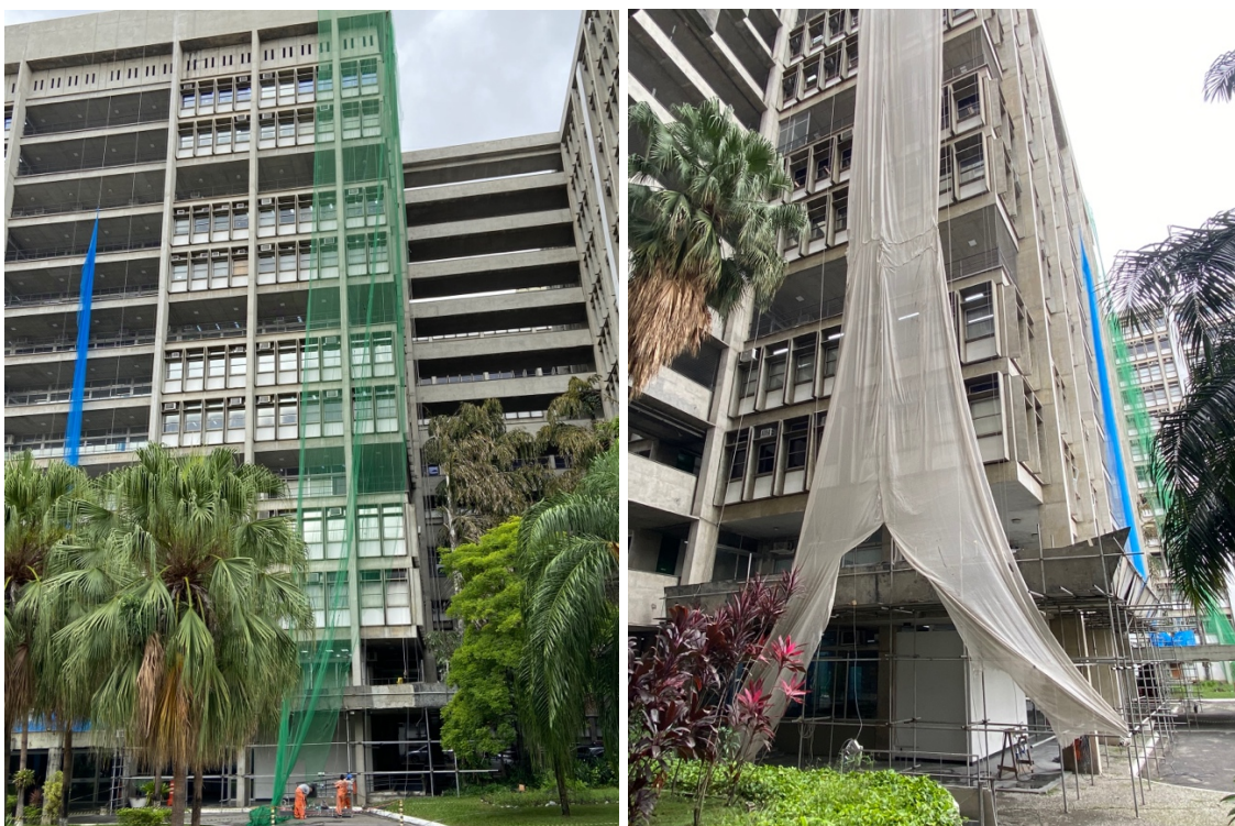
Obras de recuperação das fachadas e varandas do Bloco C – campus Maracanã (jan/fev 2020)
